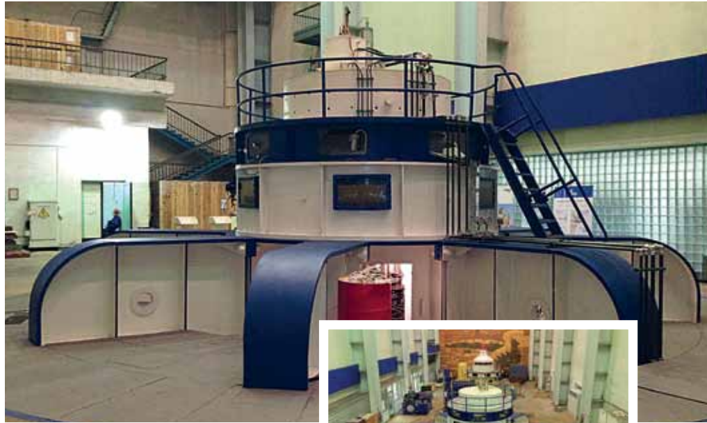
▲ Unidad 1 suministrada por ANDRITZ HYDRO
