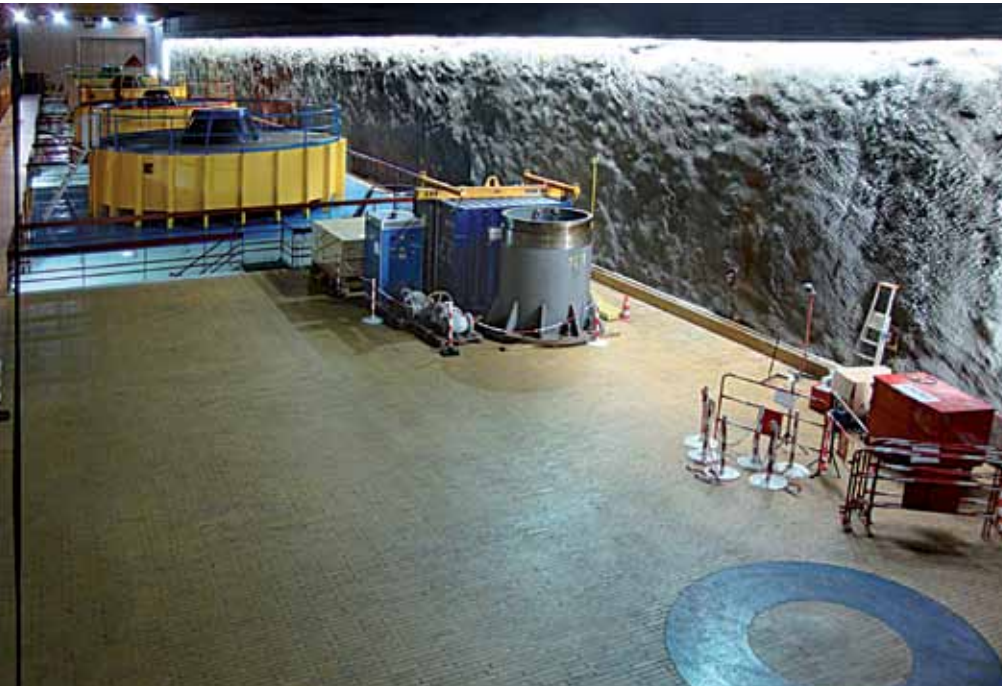
▲ Dentro de la caverna de máquinas
