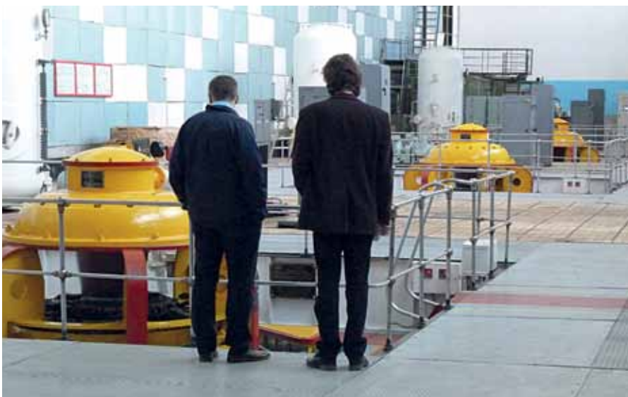
▼ Sala de máquinas
