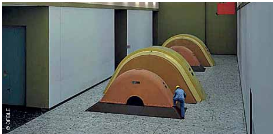
▲ Sala de máquinas
